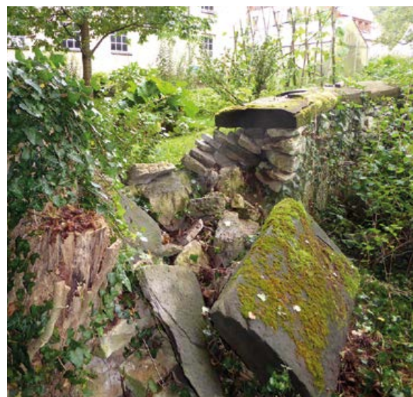
Eingestürztes Teilstück der denkmalgeschützten Trockenmauer
